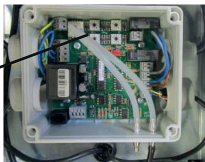
Fig. 3 Paine-eron asettaminen dekadikytkimillä. Setting of differential pressure at the decade switches
